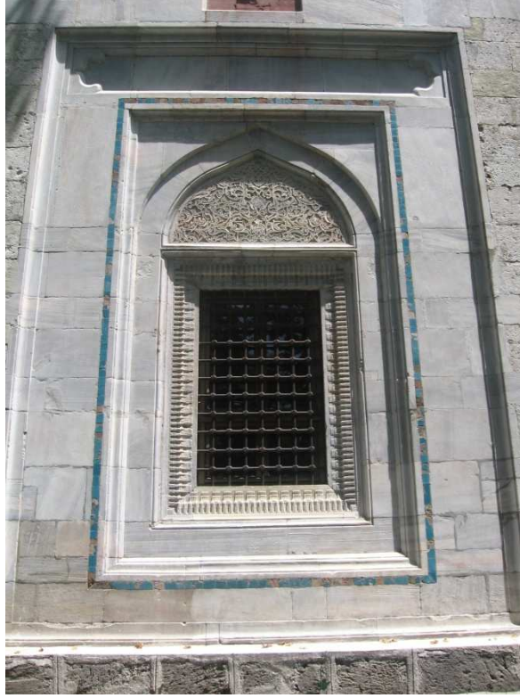
Resim 141: Bursa Yeşil Cami, batı cephesindeki pencere kenarlarındaki çiniler. (21.10.2009).
