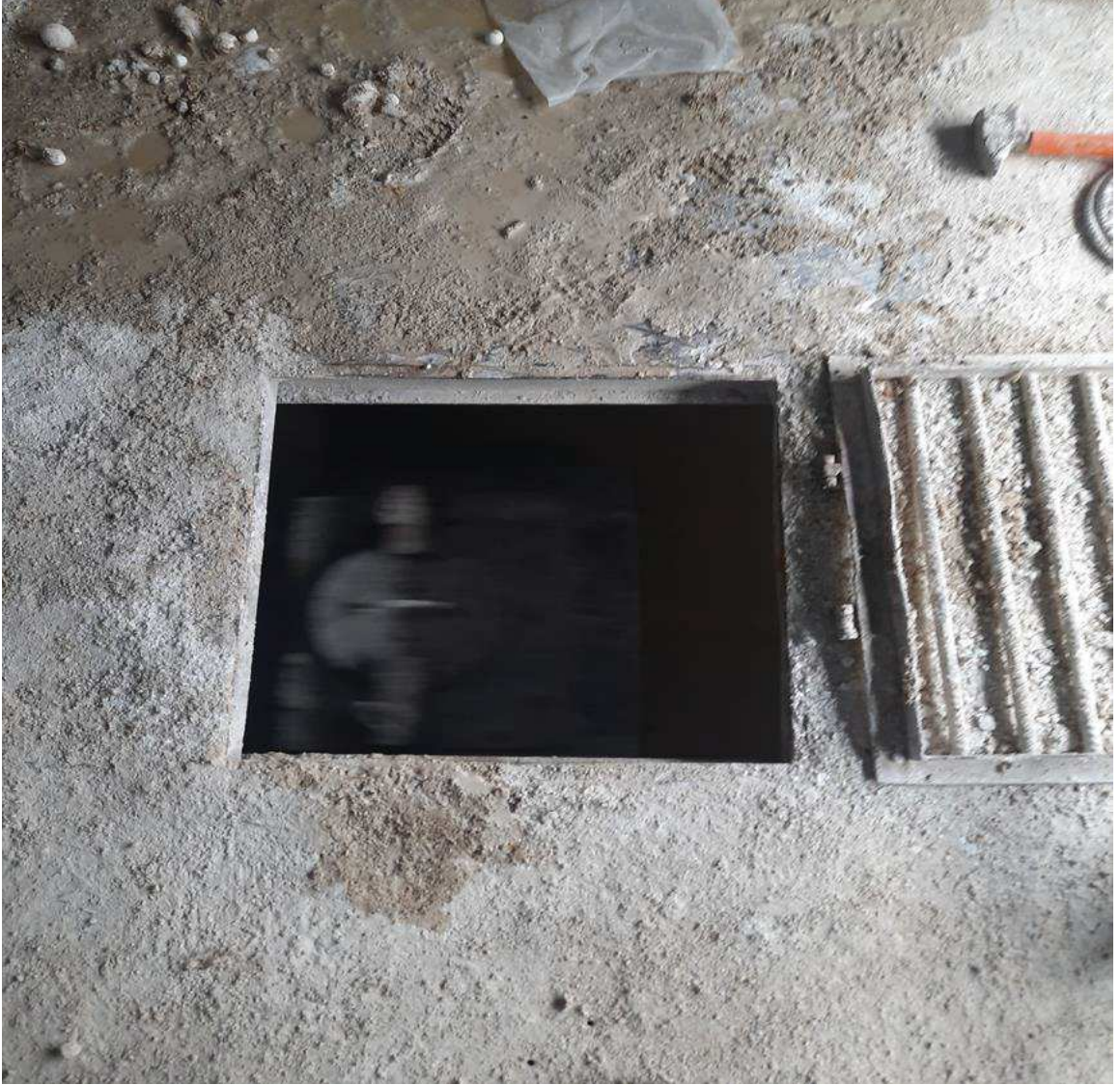
Şekil 11 Konveyör bant bölgesi platformlarında malzeme nakli için kullanılan açıklıkların bulunması
