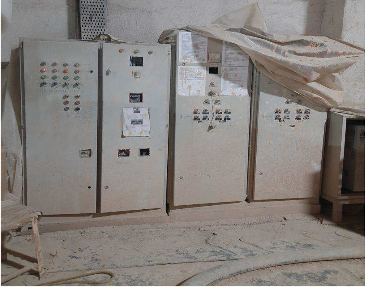
Şekil 22 Elektrik tesisatı periyodik kontrollerinin yapılmaması
