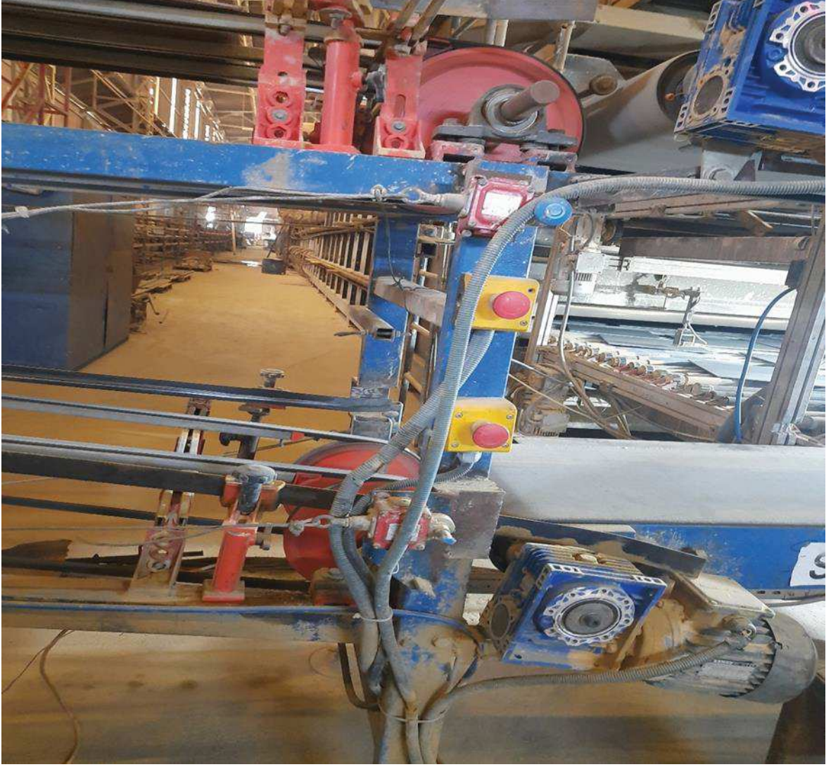
Şekil 27 Yükleme/boşaltma makineleri asansörlerinin yükleme/boşaltma kollarındaki emniyet sisteminin devre dışı bırakılması
