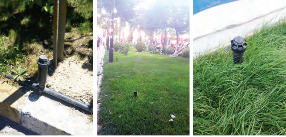
Şekil 4. Sulama başlıklarının yanlış yerleştirilmesi
