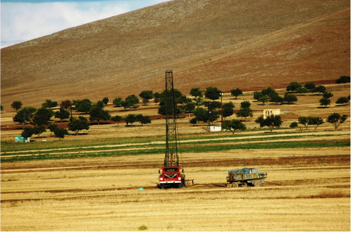
Şekil 6.9 Seyfe Gölü Havzası kaçak kuyu açımı (28.10.2009 Seyfe Havzası).
