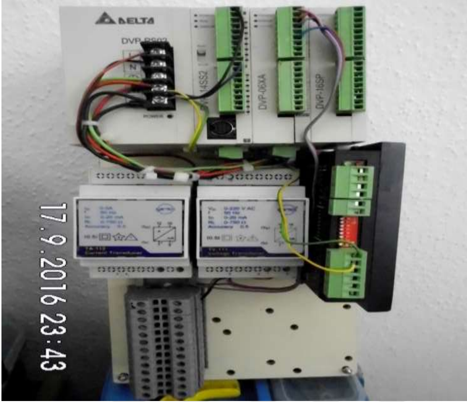
Şekil 3.1 Türbinin gelen akıntıya dik olarak konumlanması için kullanılan dairesel (yaw) dönme motoru ve step motor sürücüsü, plc control ünitesi
