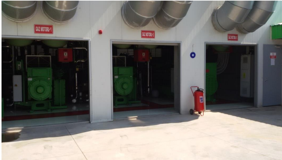
Şekil 1.12. Kojenerasyon Ünitesi (Gönen- Temmuz 2015)
