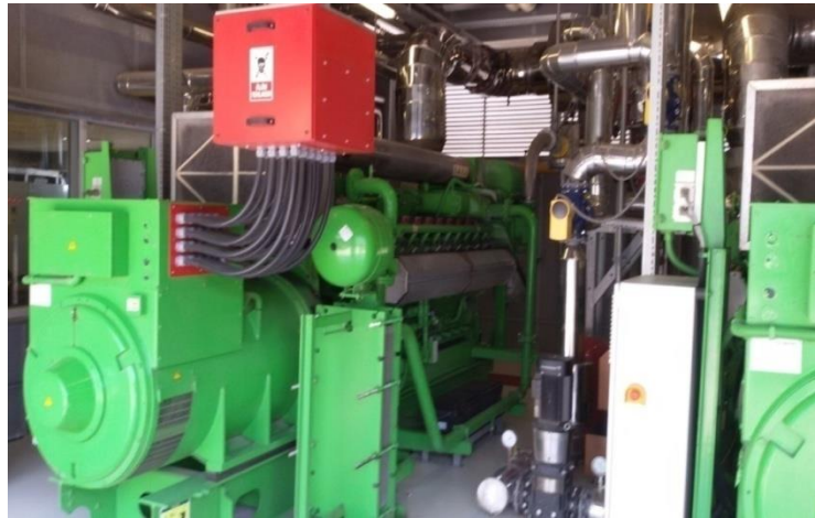
Şekil 1.23. Elektrik ve Isı Eldesinde Kullanılan Elektrik Motorları (Gönen, Temmuz 2015)
